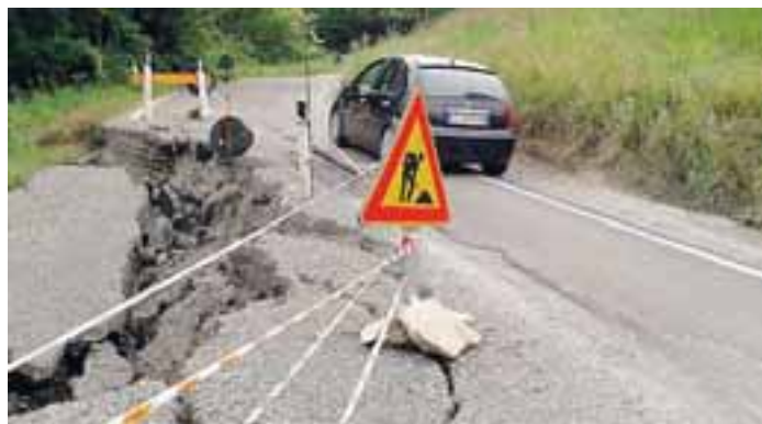
VERNASCA - La frana sulla strada provinciale di Borla (foto Meneghelli)
